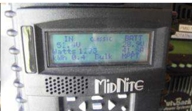
MC250 で 1.23 kW 出力中
