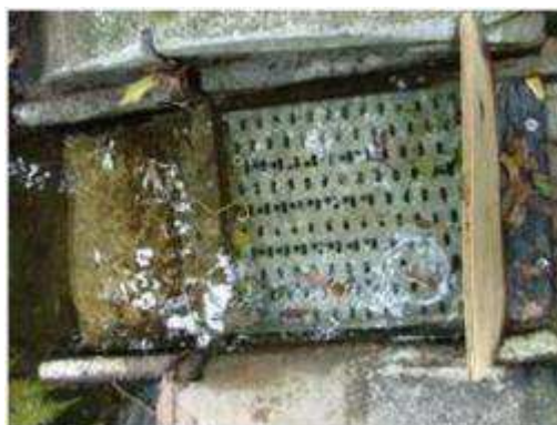
開口付メッキ済み電線用管を利用
