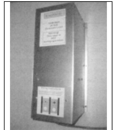
図 10-6:余剰電力の消費にはヒーター負荷がその場所の割りに最大の効率を上げます。この小さな箱で 1Kw を受け持っています。
