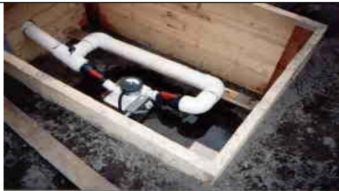
図 8-2: ターゴ型回転体水力発電機は高ヘッド、低流量に適しています。カナダの取り付け例です。
