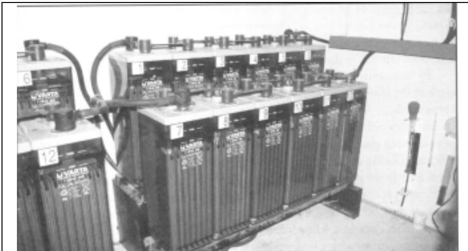
図 9-16：蓄電池収納場所はこの様に整理整頓、清潔管理が特に必要とされます。電池の健康診断の為に比重計、温度計、それに記録管理のためのノートを用意し、直電池の長寿命使用を行います。
